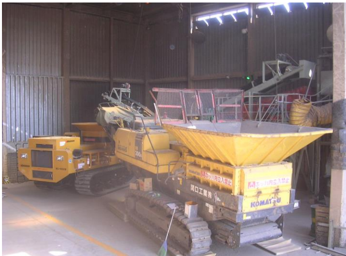
・木くず破碎施設
